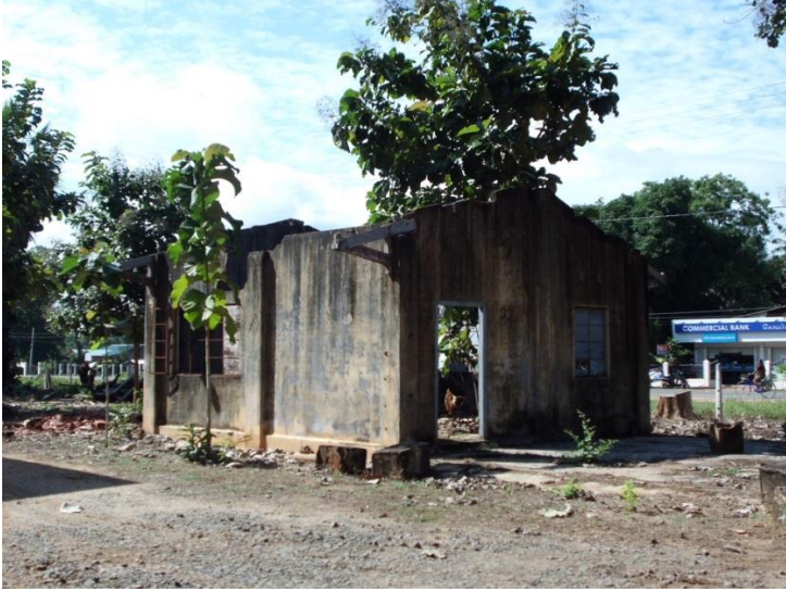
(写真1) 破壊された倉庫事務所
